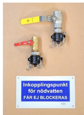
Inkopplingspunkt försedd med skyddslock samt informationsskylt
